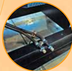
Подводящий и обратный шланги, отсоединенные от встроенного топливного бака
